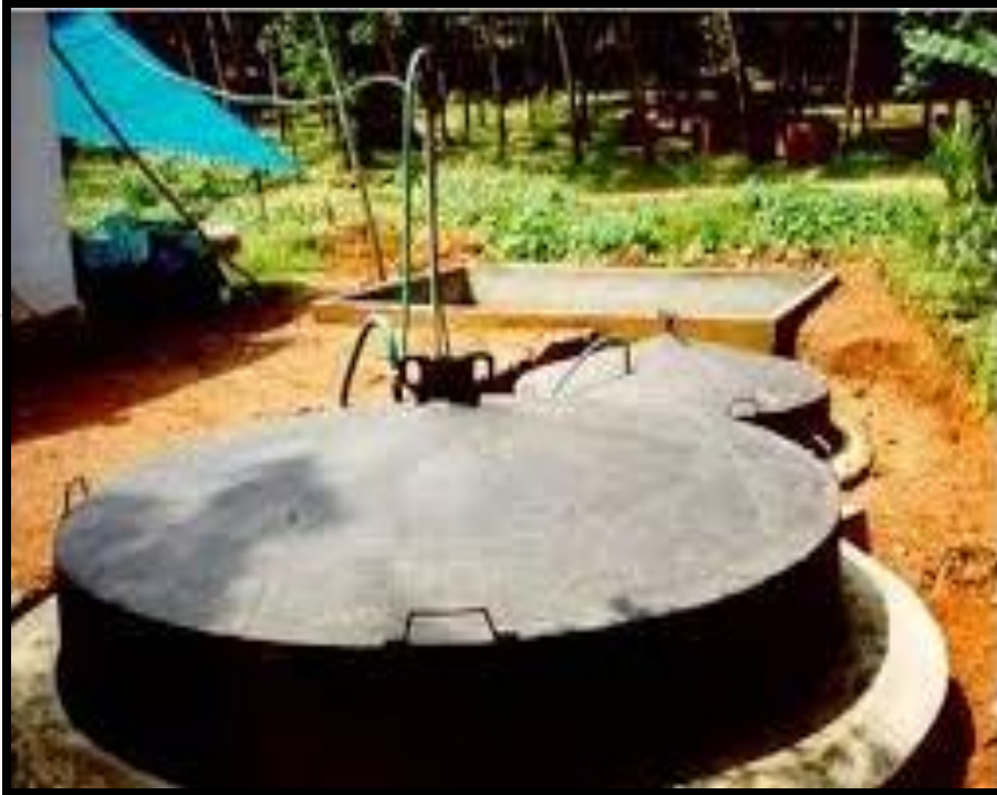
Tank Penampung Biogas
