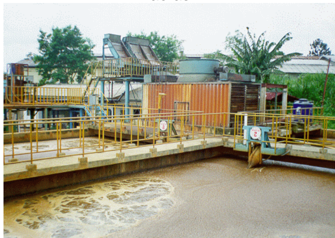
Gambar 11. Menara pendingin (Colling Tower) sebelum air masuk ke dalam bak aerasi
